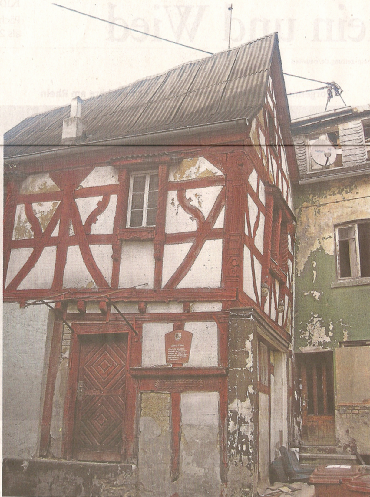
Das marode Wohnhaus (rechts) soll bald abgerissen werden und einem neuen Dorfplatz weichen. Die untere Mühle mit dem Fahrer Backesmännchen soll nach und nach denkmalgerecht saniert werden.
